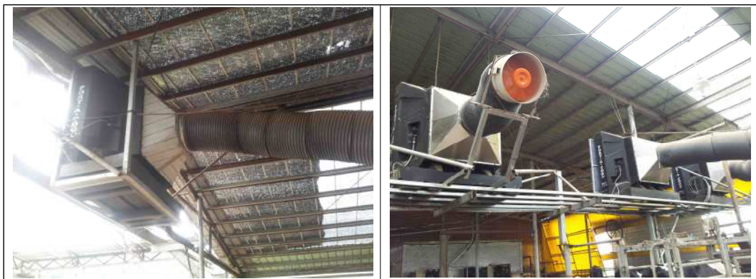
<그림 5> 축사 내 터널식 쿨링시스템(덕트) 가동 장면
